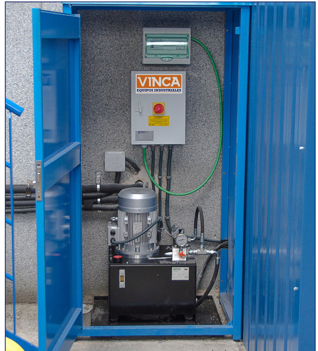
Groupe moto pompe + panneau électrique
